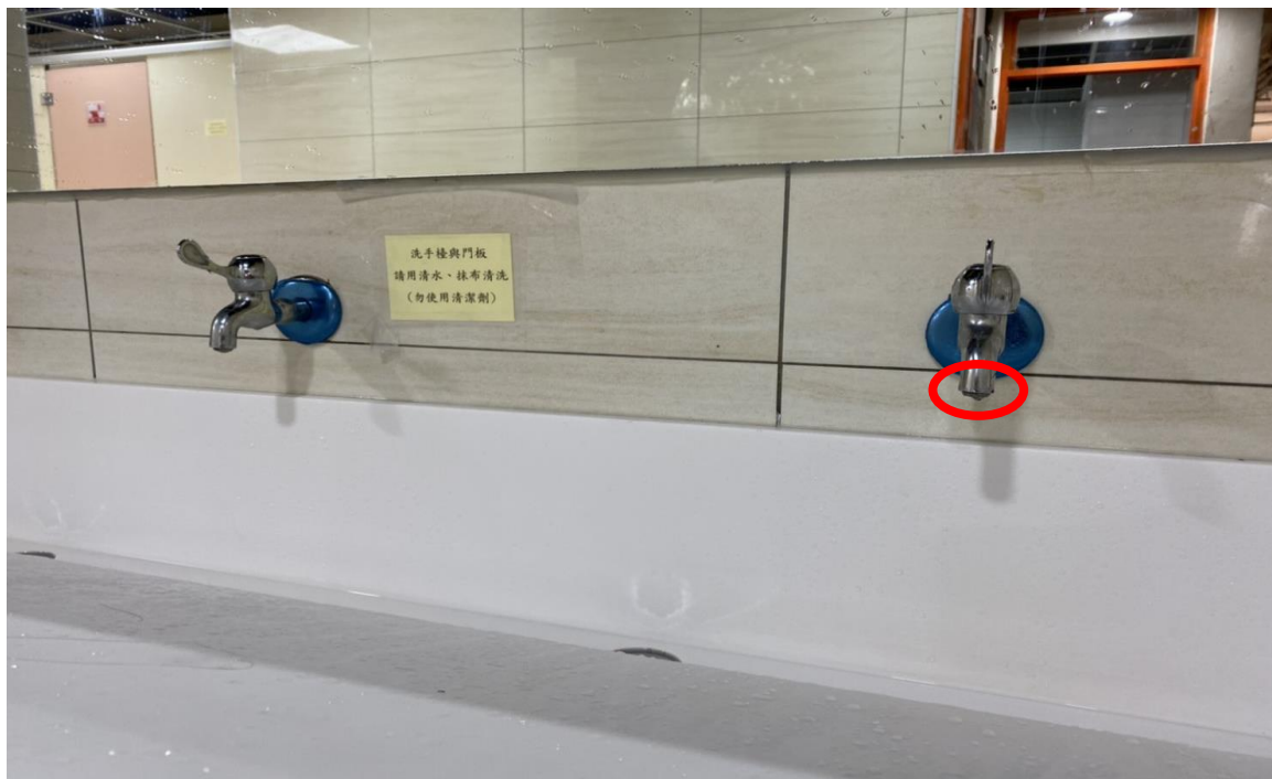
照片說明：水龍頭裝設省水裝置
