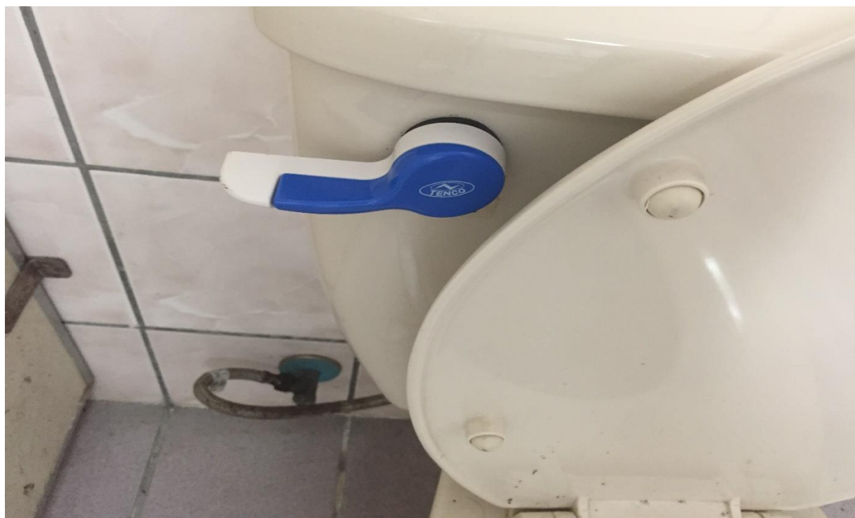
照片說明：注重能源節約，設有省水裝置
